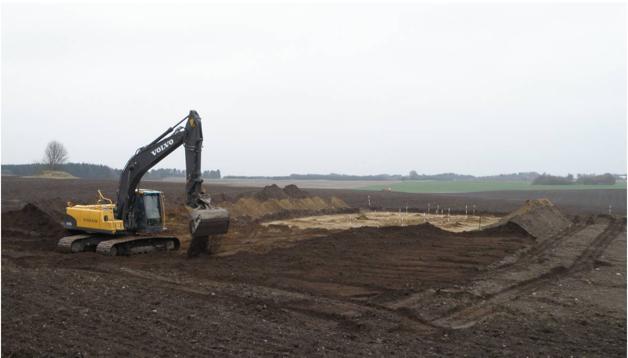
Tildækning af sydlige halvdel af felt. Bemærk udlagte råjord forud for tildækning med muldjord. I baggrunden ses gravhøj sb. nr. 142. April 2011
